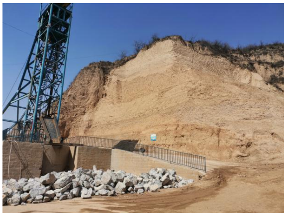
照片 8-2-1 W1 未治理边坡现状(镜向 WN)
