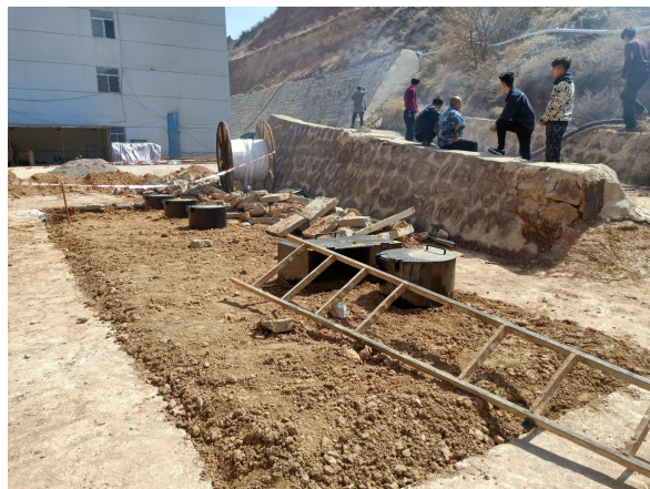
照片 8-2-20 地埋调节池
