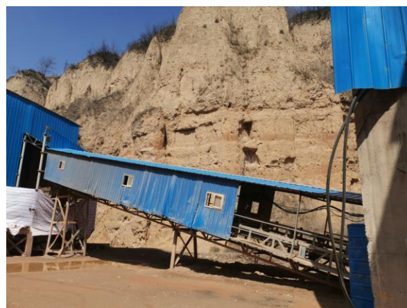
照片 8-2-6 W3 不稳定斜坡现状（镜向 N）
