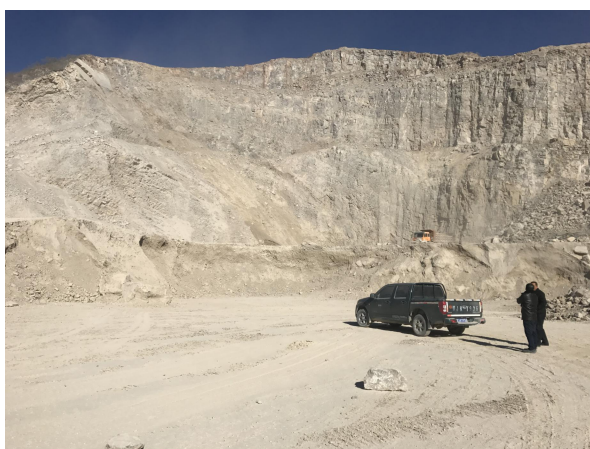
照片 8-1 XP1 不稳定边坡（镜向 N）
