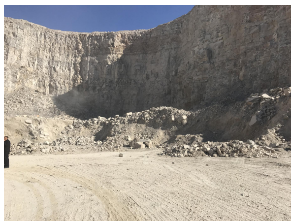
照片 8-2 XP1 不稳定边坡（镜向 NE）
