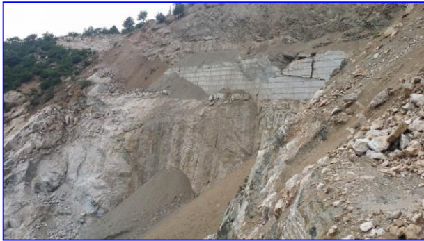
照片8-2-1 W 1 不稳定斜坡（镜向NW）
