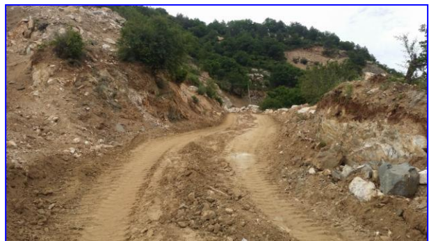
照片8-2-2 W 2 不稳定斜坡（镜向NE）
