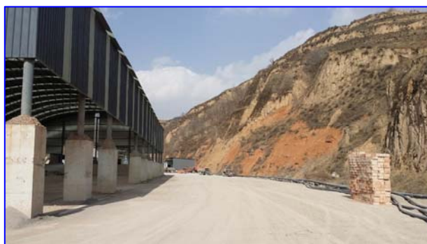
照片 8-2-7 W_2 不稳定斜坡(镜向 NE)
