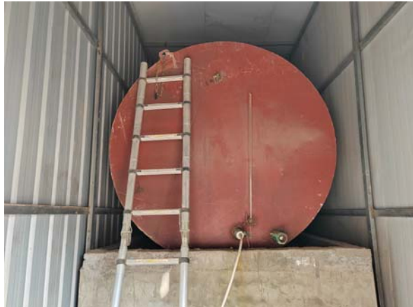
照片 8-2-35 甲醇储罐
