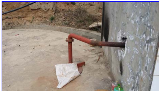
照片 8-2-18 南岭村供水深井(镜向 NE)
