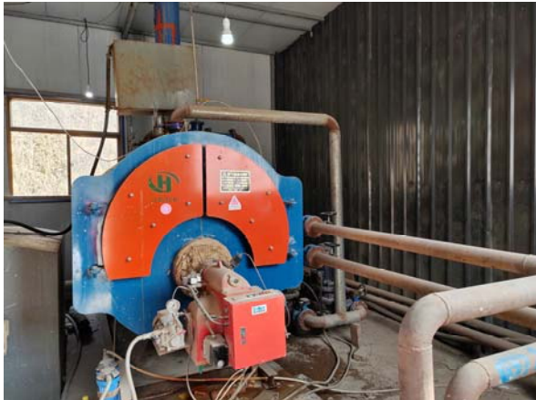
照片 8-2-34 甲醇锅炉
