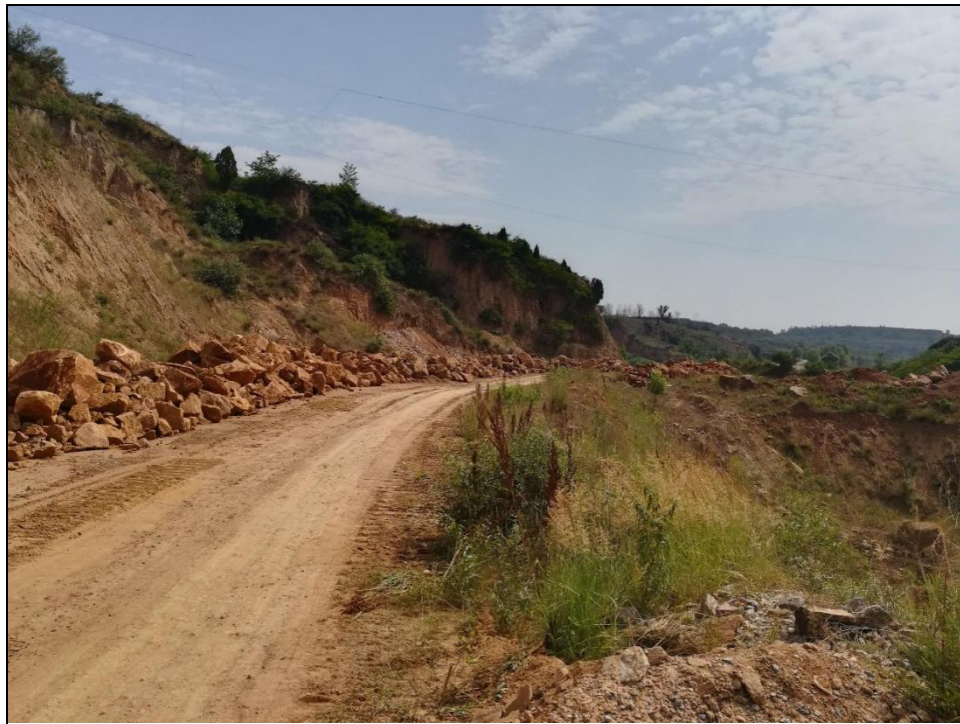
照片8-2-1-1 W_1 不稳定边坡（镜向N）
