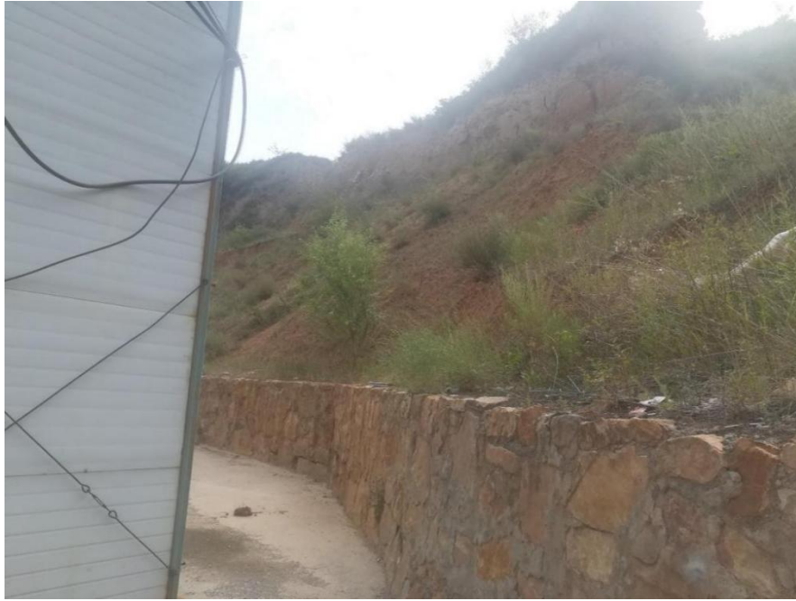
照片 8-2-1-2 W_2 不稳定边坡（镜向 NE）
