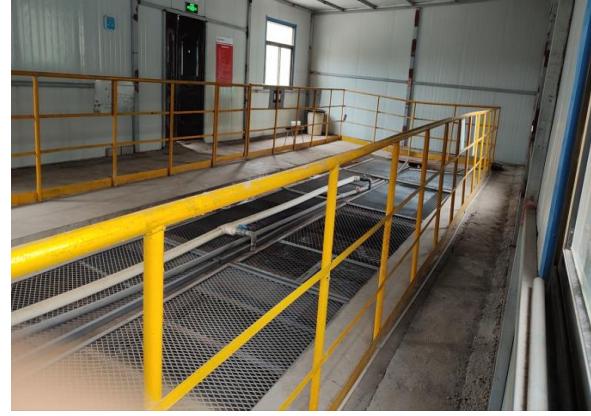
照片 8-2-13 生活污水处理内部
