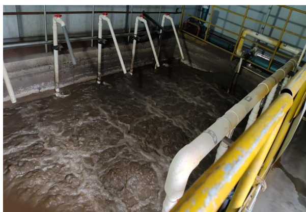
照片 8-2-12 生活污水处理内部
