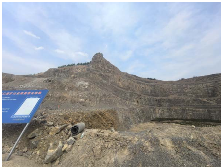
照片 8-1 XP1 不稳定边坡（镜向 N，2025. 11）
