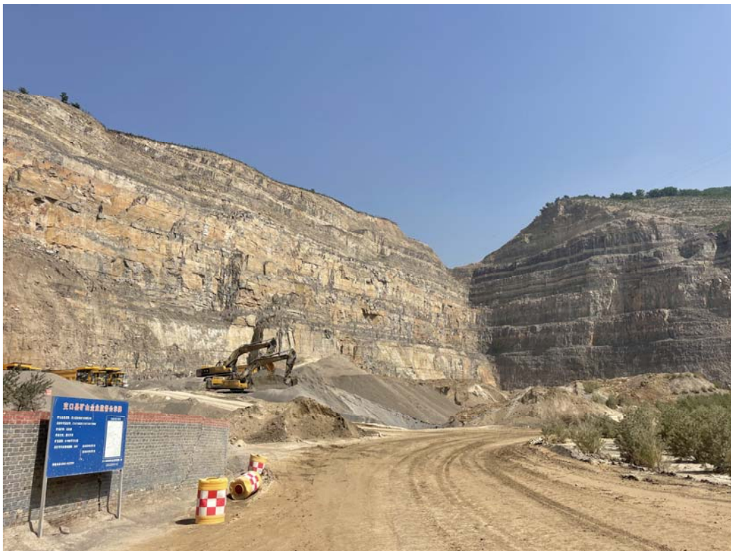
照片 8-2 XP1 不稳定边坡（镜向 NE，2025. 10）
