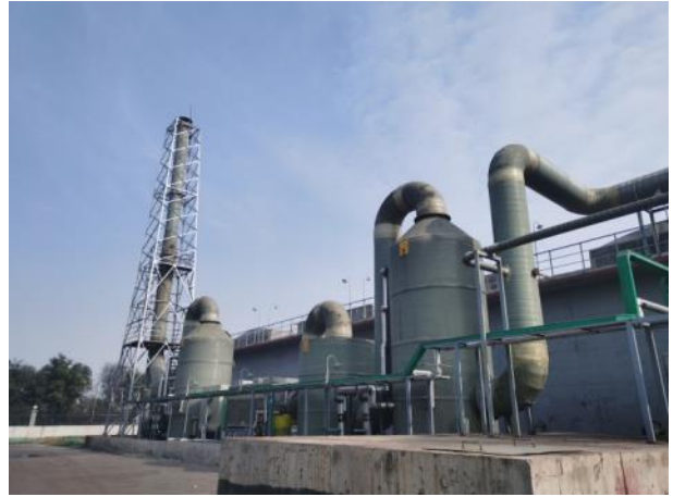
污水处理站废气治理设施
