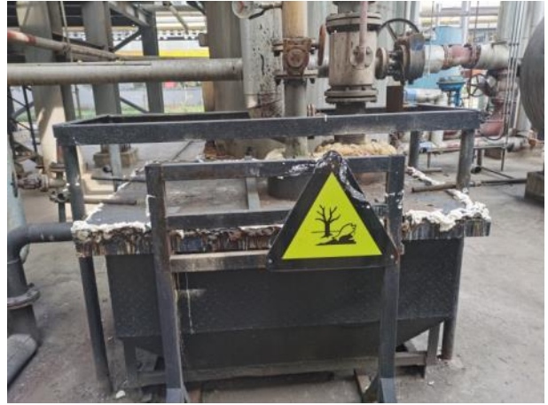
密闭蒸氨残渣槽
