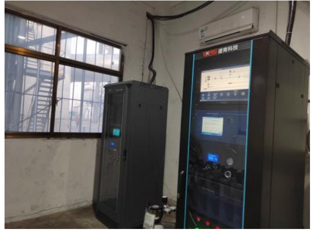
焦炉烟囱 CEMS 站房内部
