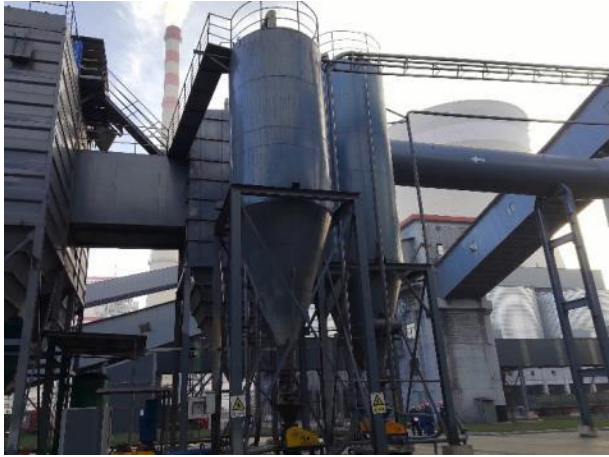
推焦除尘地面站脱硫剂仓
