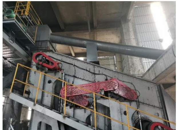
筛焦楼振动筛收尘管道
