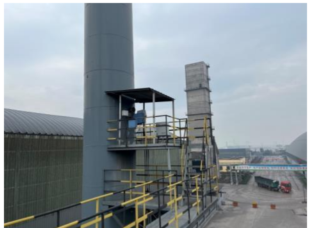
推焦废气排放口监测平台
