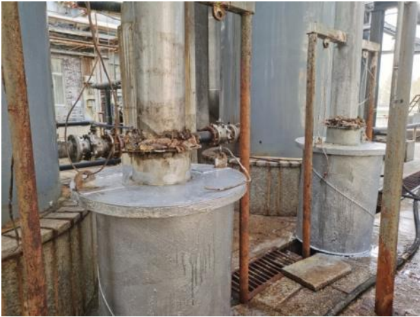
密闭酸焦油收集槽
