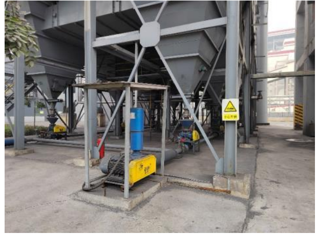
筛焦除尘器气力输灰装置
