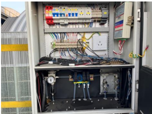
机侧炉头烟废气排放口采样平台固定电源
