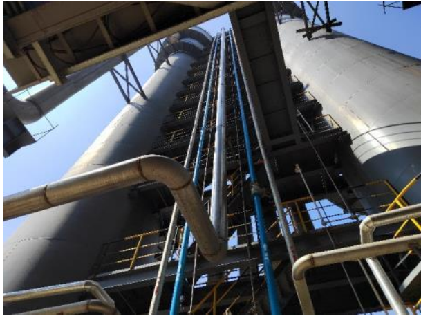
再生塔 VOCs 废气收集管线
