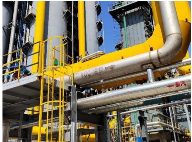
VOCs 废气送焦炉燃烧
