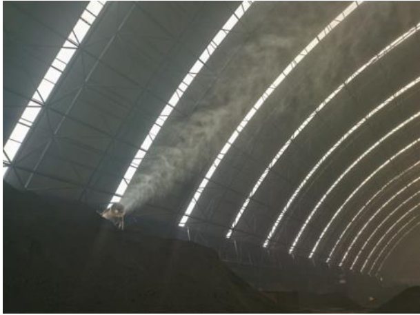
精煤棚内雾炮
