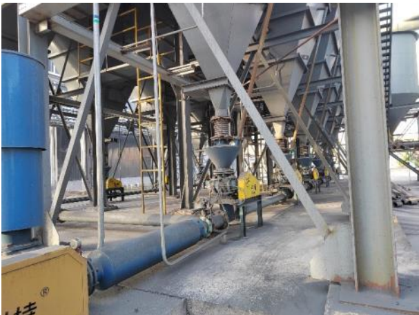
干熄焦除尘地面站气力输灰装置
