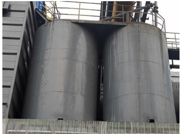
机侧、推焦除尘地面站储灰仓
