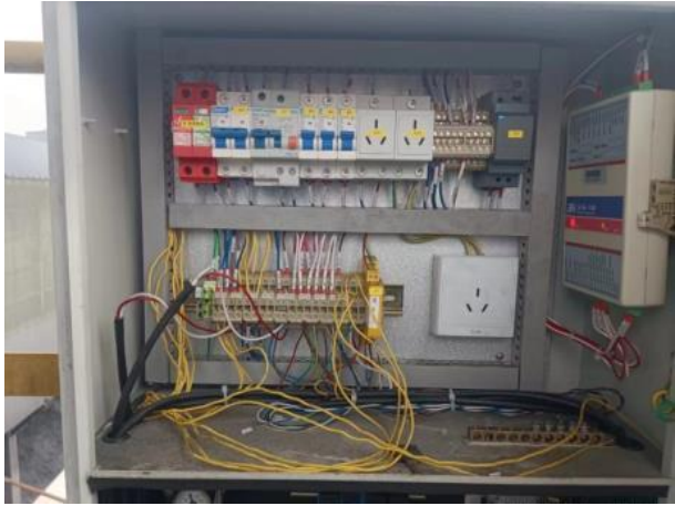
推焦废气排放口采样平台固定电源
