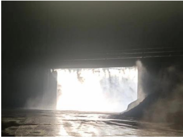
煤棚出入口雾帘启动
