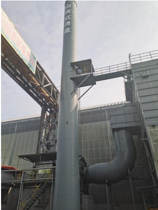
机侧炉头烟废气排放口
