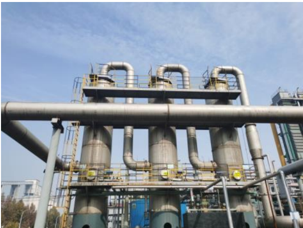
VOCs 废气“油洗+酸洗+碱洗”装置
