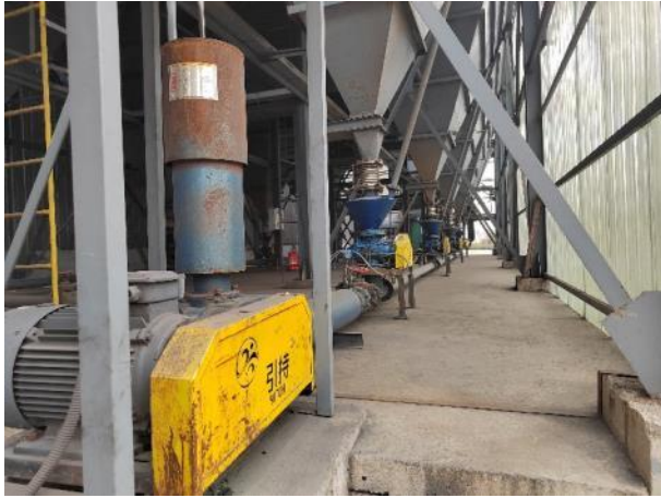
机侧地面站气力输灰装置
