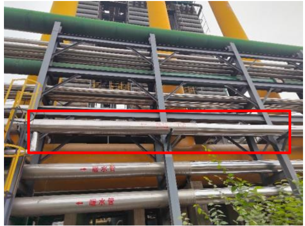
VOCs 负压管道
