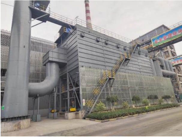
机侧炉头烟袋式除尘器
