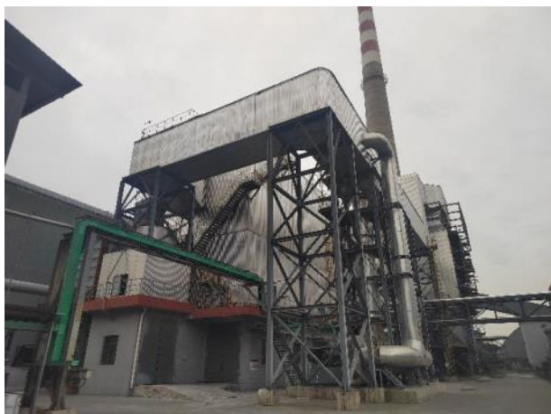
焦炉烟气袋式除尘地面站+SCR脱硝
