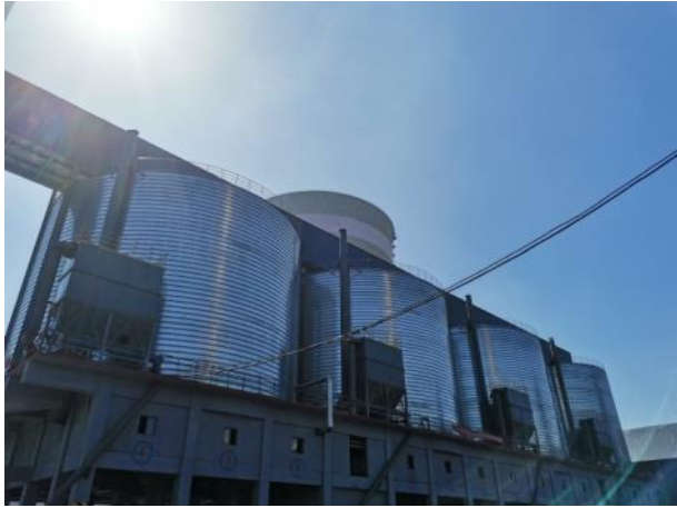
焦仓仓底 1#2#3#4#袋式除尘器
