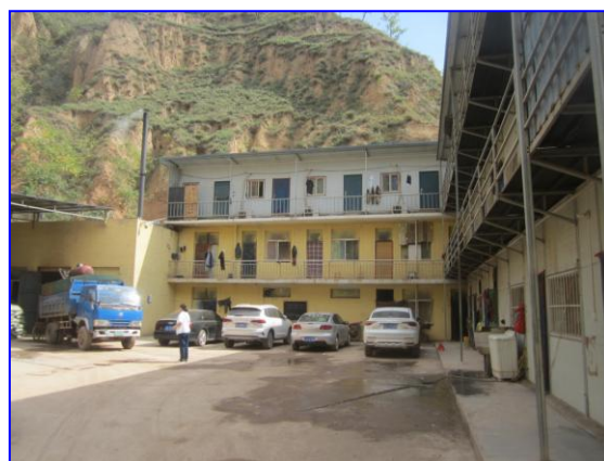
照片 8-2-10 W 2 不稳定边坡(镜向 NE)
