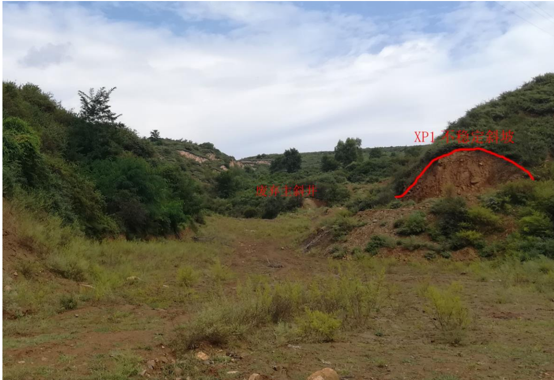
照片 8-2-1 废弃主斜井东南方 5m 处不稳定斜坡 XP1
