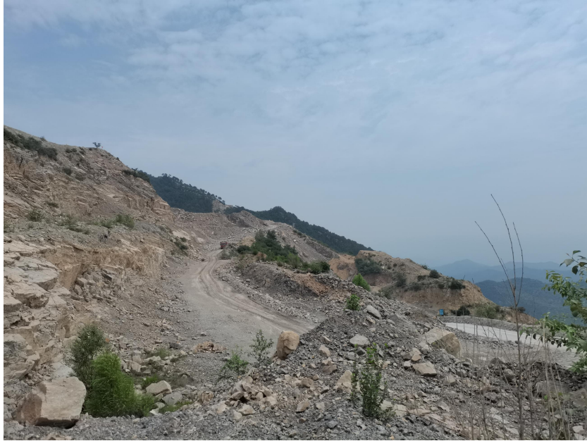
照片 5-2-2 不稳定边坡 XP2 (镜向南)
