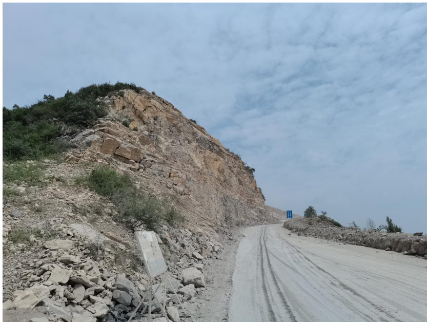
照片 5-2-3 不稳定边坡 XP3 (镜向北)
