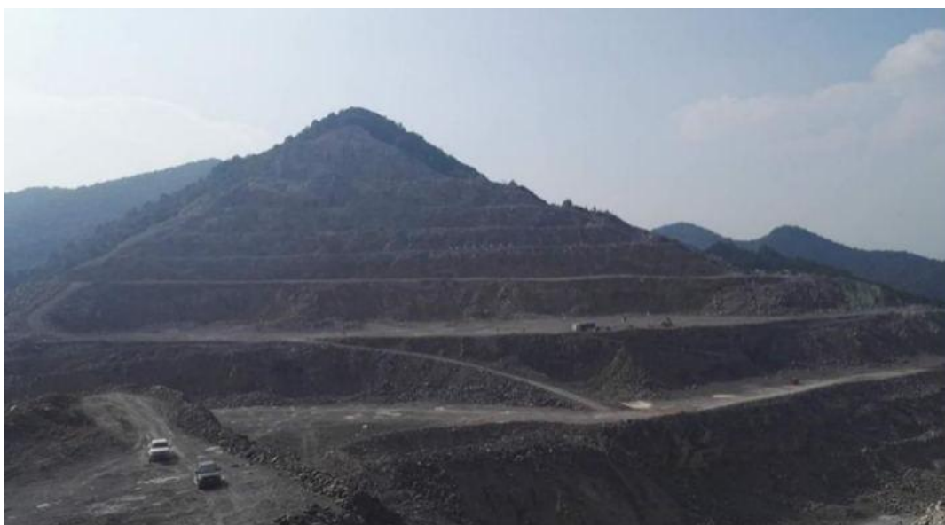
照片 5-2-1 不稳定边坡 XP1（镜向南）
