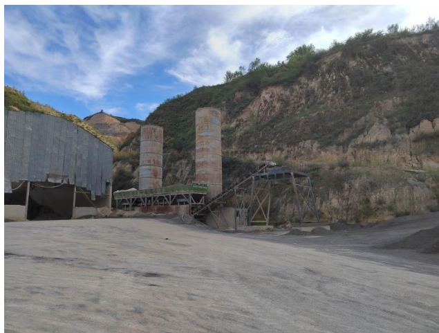
照片 8-2-3 不稳定边坡 BP3
