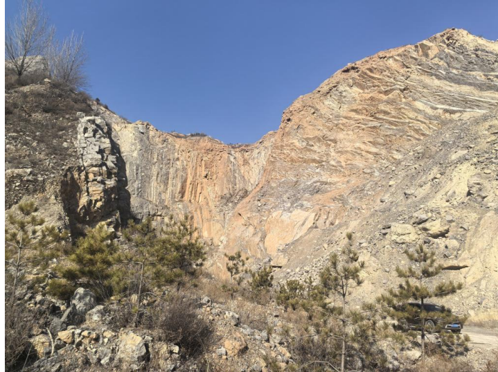
照片 8-2-5 BW4 不稳定边坡照片
