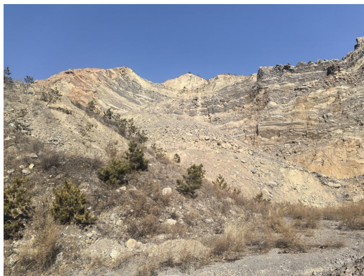
照片 8-2-6 BW5 不稳定边坡照片
