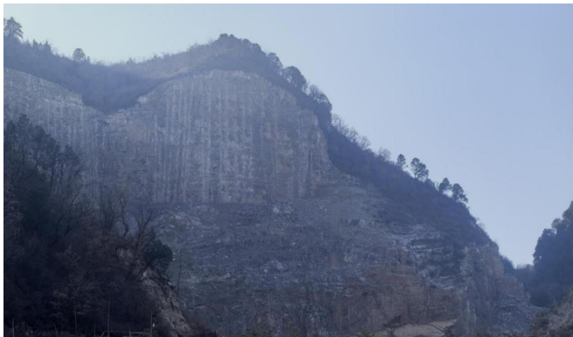
照片 8-2-1 BW1 不稳定边坡照片
