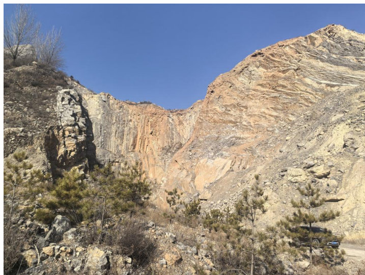
照片 8-2-5 BW4 不稳定边坡照片
