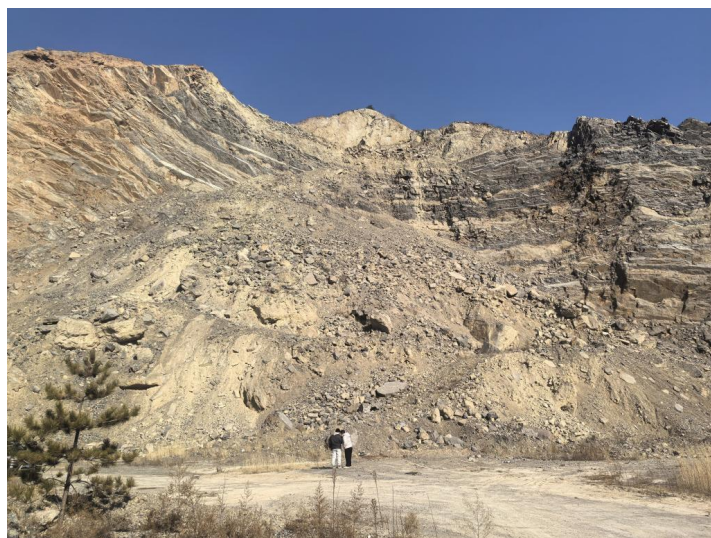
照片 8-2-3 BW3 不稳定边坡照片
