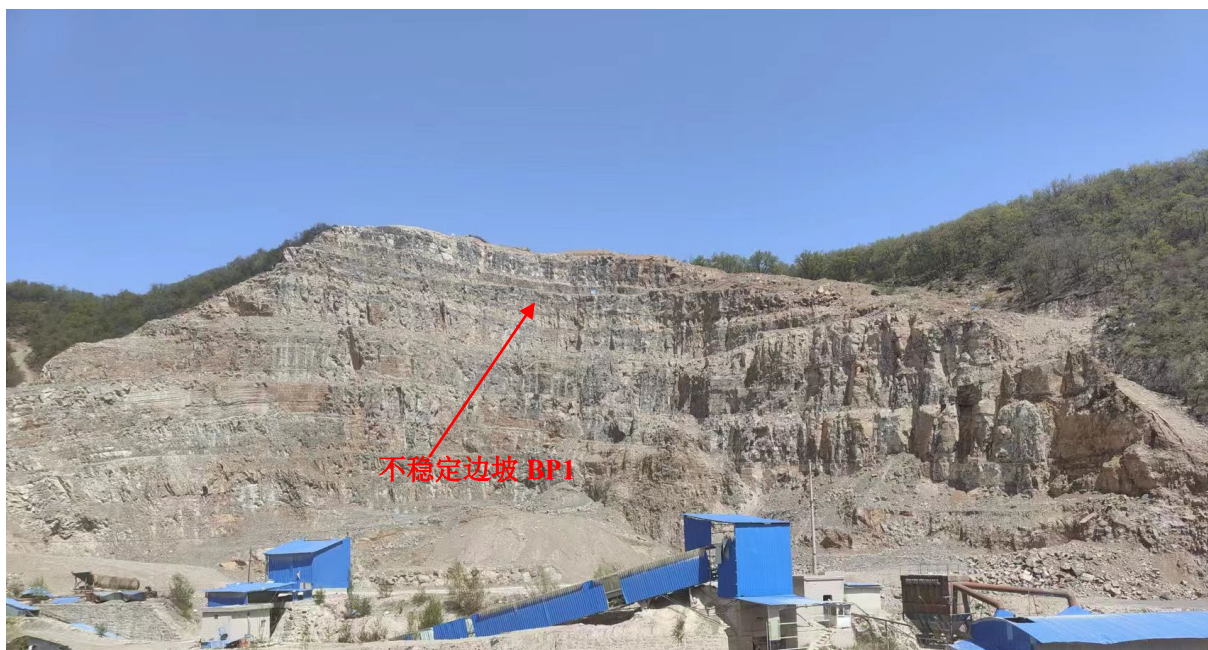
照片 8-2-1 不稳定边坡 BP1
