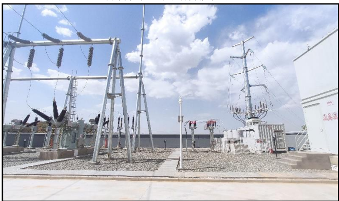
风电场升压站
