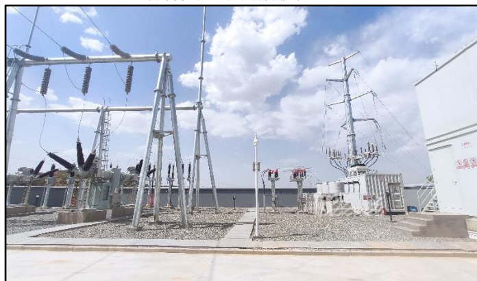
风电场升压站
