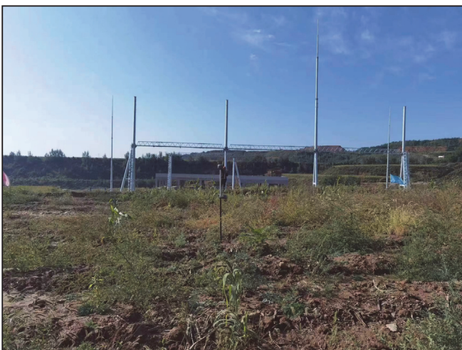
依托交口 220kV 变电站
