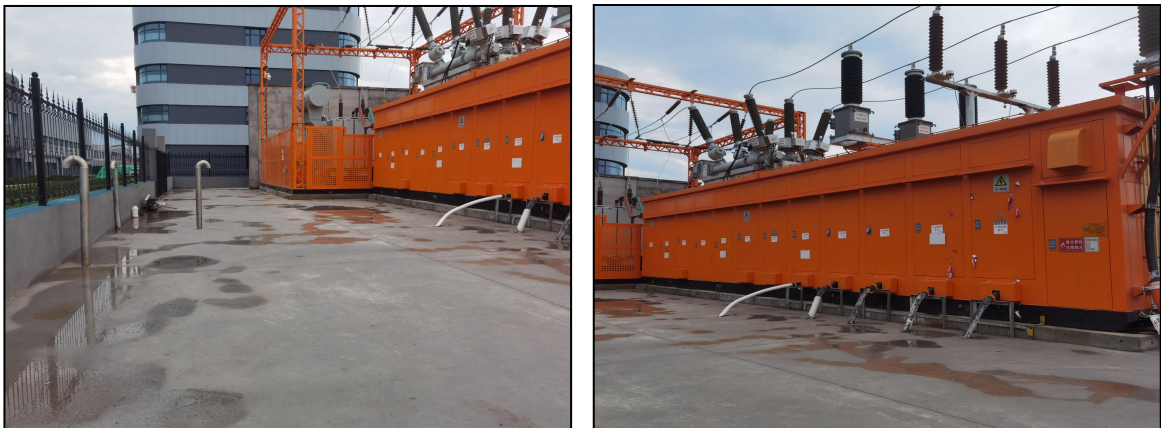
类比的柏板 110kV 移动变电站主变及配电装置
