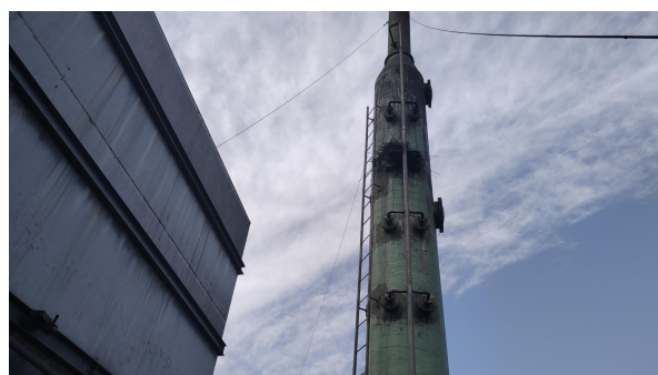
现有除尘及排气筒
