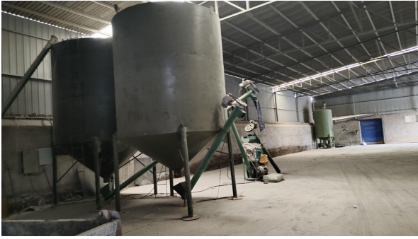
高粱、曲块破碎存储间
