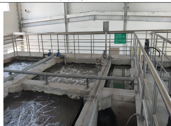
生活污水处理站 (SBOT 池)
