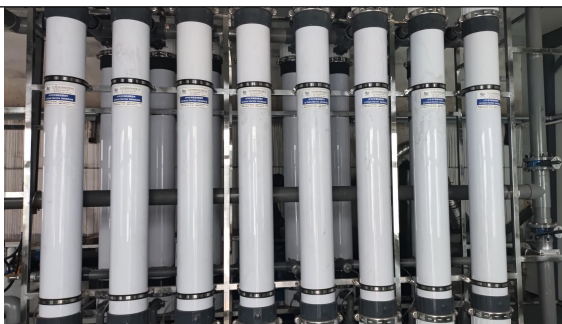
矿井水处理站超滤装置
