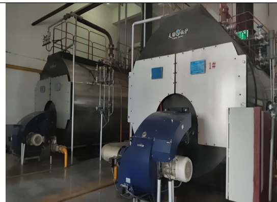
燃气锅炉及低氮燃烧器
