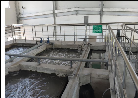
生活污水处理站 (SBOT 池)
