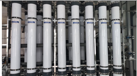
矿井水处理站超滤装置
