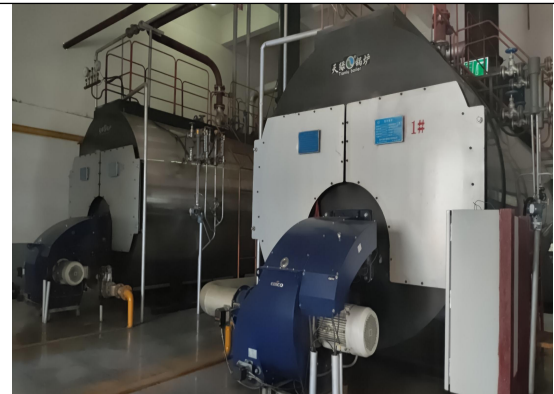
燃气锅炉及低氮燃烧器
