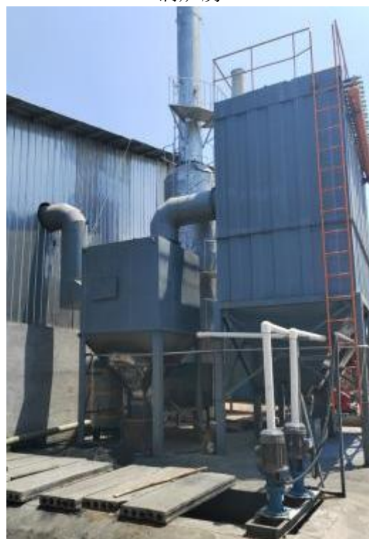
锅炉脱硫除尘器
