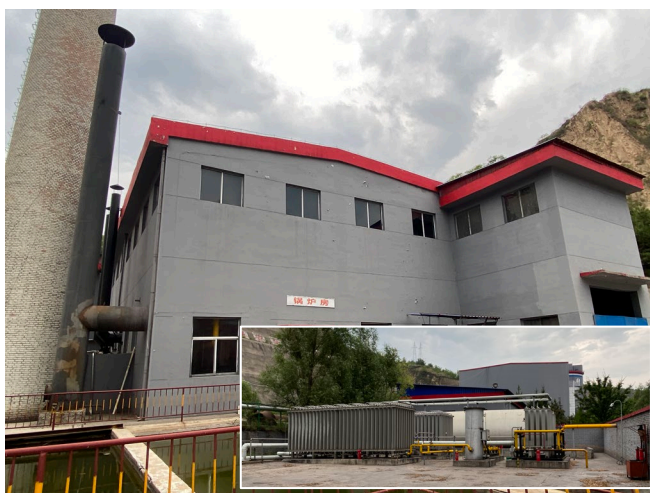
燃气锅炉房及 LNG 储罐
