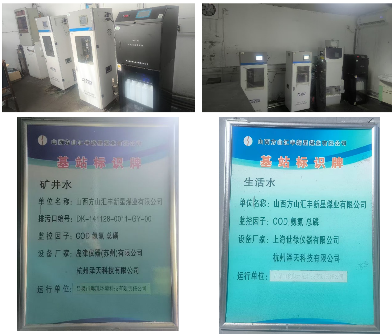
图 3.1-6 新星煤矿矿井水及生活污水在线监测设施及标牌
