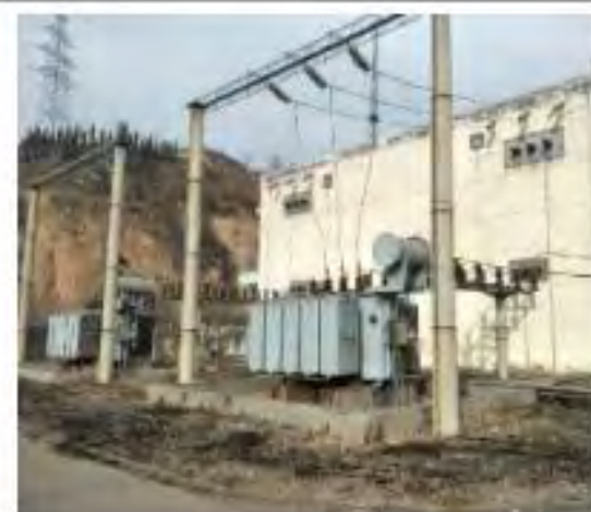
已建 35kv 变电站
