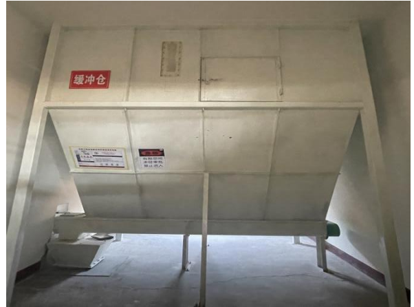
曲料破碎车间缓冲仓
