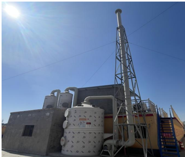
污水站除臭系统
