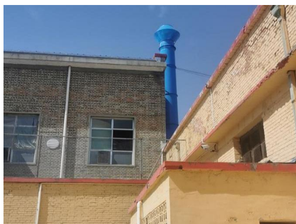
原料破碎车间排气筒
