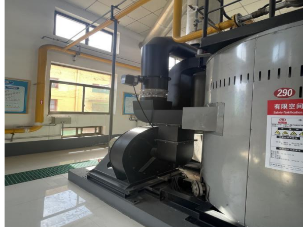
锅炉低氮燃烧设备
