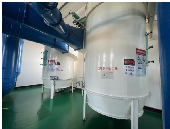
原料破碎车间除尘器
