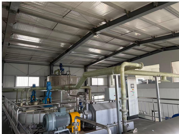
餐厨废弃物处理车间内部废气收集管道
