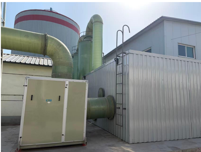
恶臭废气处理装置
