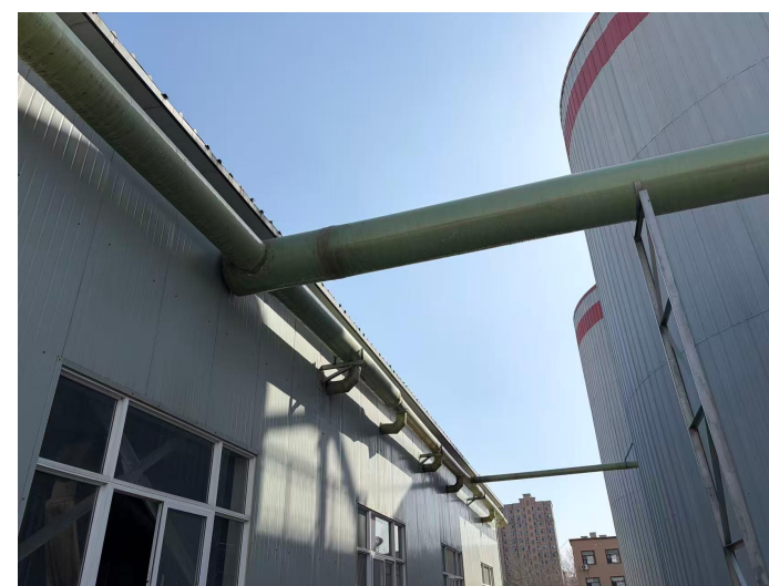
车间恶臭气体集气管道
