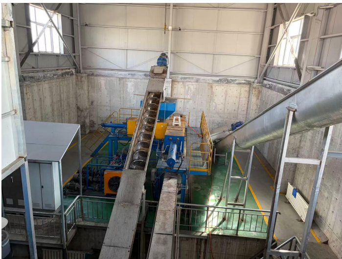
预处理车间内部
