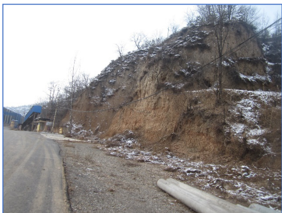
照片 8-2-11 W1 不稳定边坡(镜向 WS)
