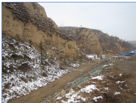
照片 8-2-12 W1 不稳定边坡(镜向 EN)
