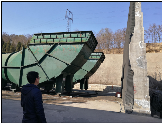
消音器和扩散塔、隔声墙
